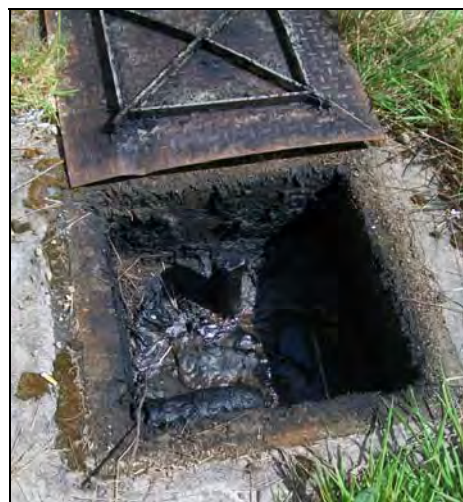
Figure 20 : Cuve d'huiles usées (11.019.RA.002.01.fig21)
